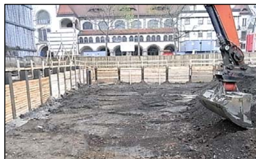
Abb. 4. Schichtenweiser Abtrag, verpflichtend bei baubegleitender KMR
